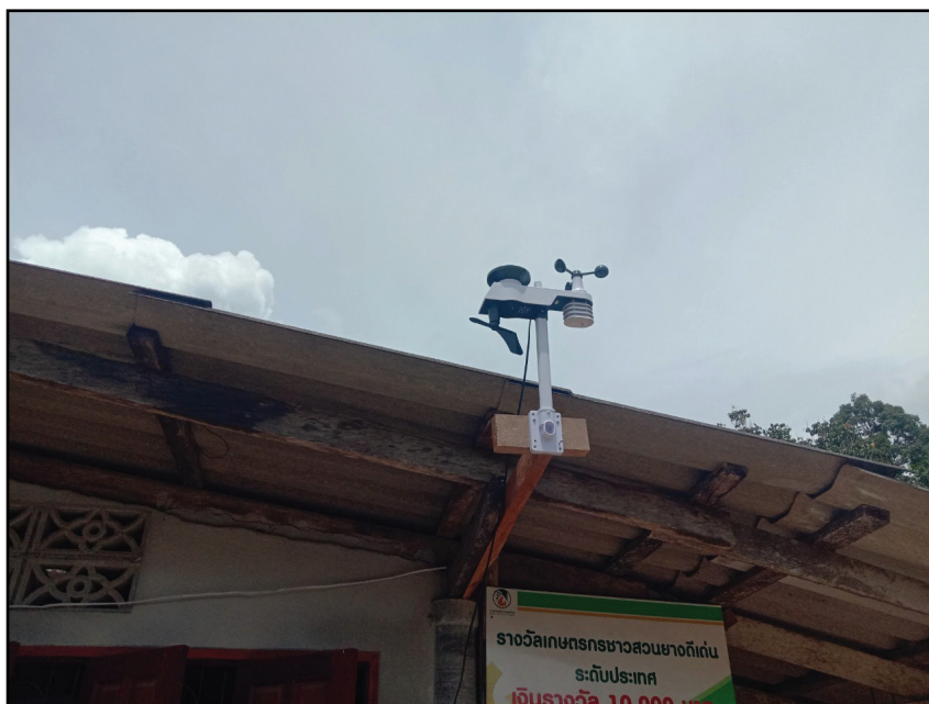
ภาพที่ 1 การติดตั้งสถานีตรวจวัดสภาพอากาศแบบชั่วคราว
